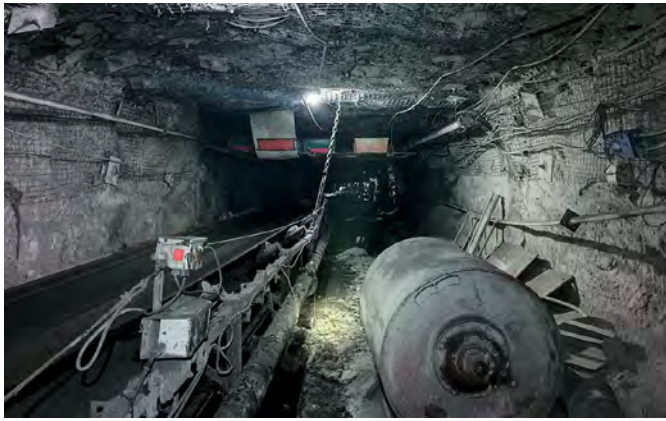
Рис. 1 Начало контролируемого участка: приводной барабан ленточного конвейера и начало водяного заслона
