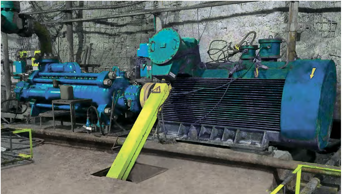
Рис. 4 Насос на месте эксплуатации
